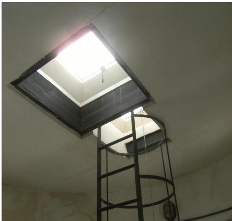
Figura 1.101. Detalle de lucernario en la Torre de los Perdigones en la actualidad.
