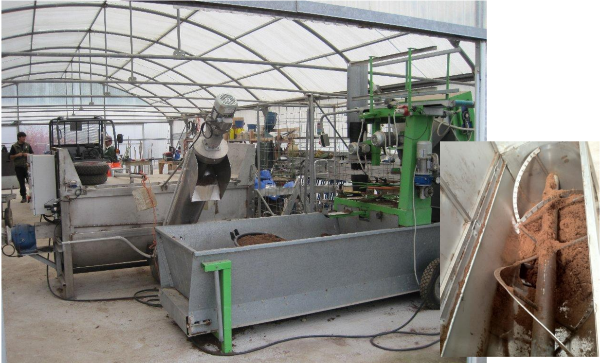
Fotografía 11. Mezcladora con detalle interior.
