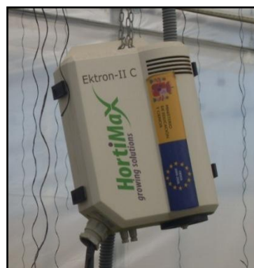
Figura 10. Detalle del sensor de temperatura, humedad relativa y CO 2 .
