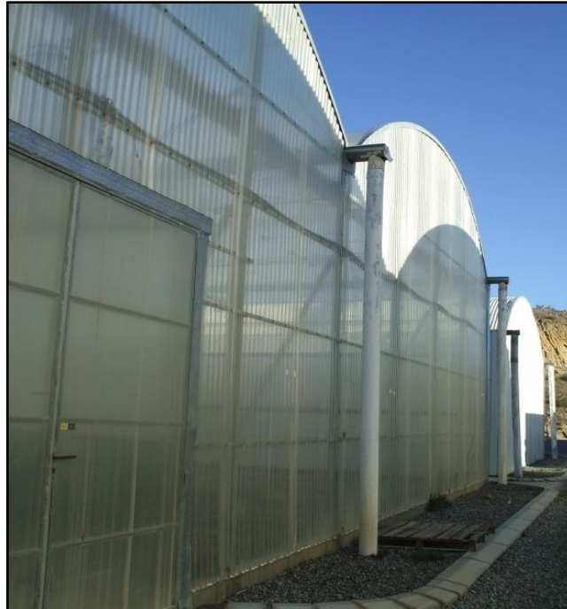
Figura 12. Detalle de las canaletas de recogida de aguas de lluvia.
