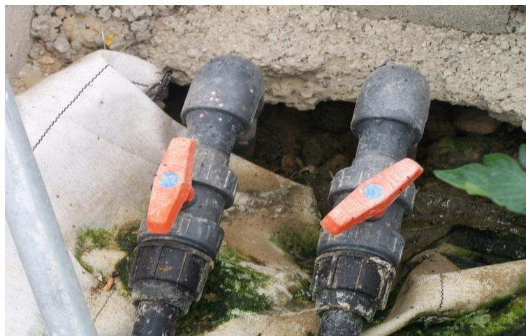
Figura 45. Detalle de las tuberías que suministran el riego en dos de los sectores del invernadero.
