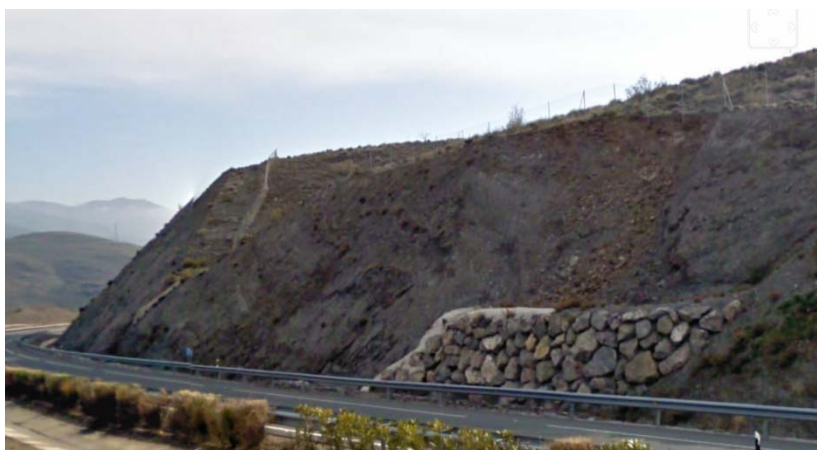
Fig 2.1.4. Imagen del talud cuando todavía no se había producido el deslizamiento (www.googleearth.com)
