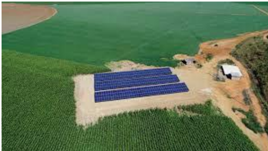
Fotografía 4. Planta fotovoltaica acoplada a riego sectorizado.
