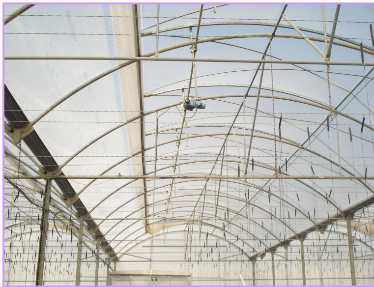
Figura 65. Detalle de la ubicación del motor de apertura de las ventanas supercentrales.
