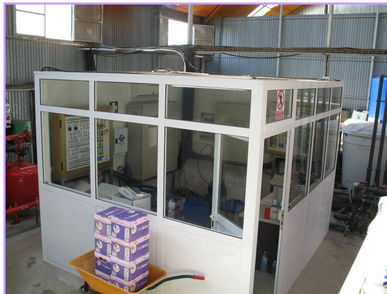
Figura 55. Detalle de la sala de control en el cabezal de riegos.
