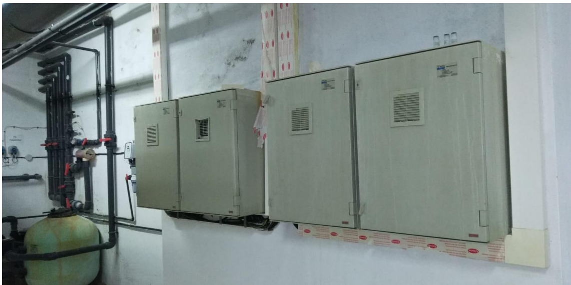
Ilustración 25. Subcuadro transformador luminaria
