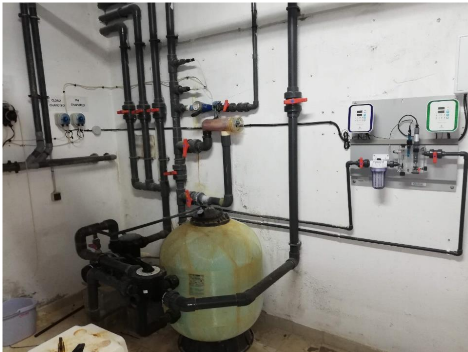
Ilustración 21. Filtro piscina de chapoteo
