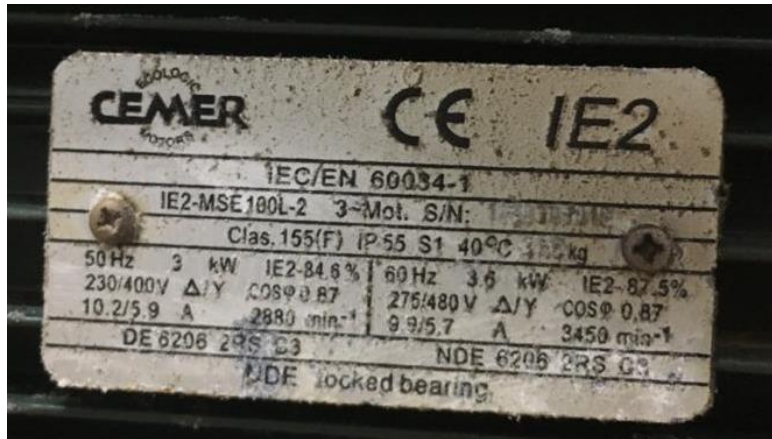
Ilustración 17. Placa características motor, piscina 400
