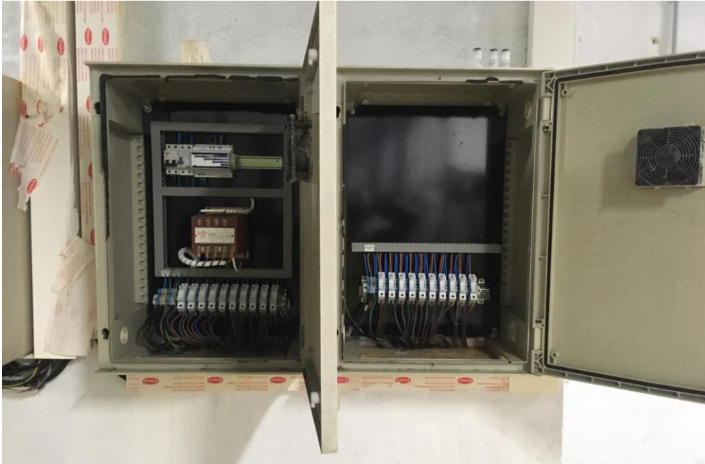
Ilustración 26. Interior subcuadro transformador luminaria
