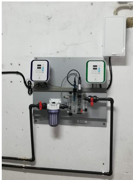
Ilustración 27. Equipo dosificación automatico
