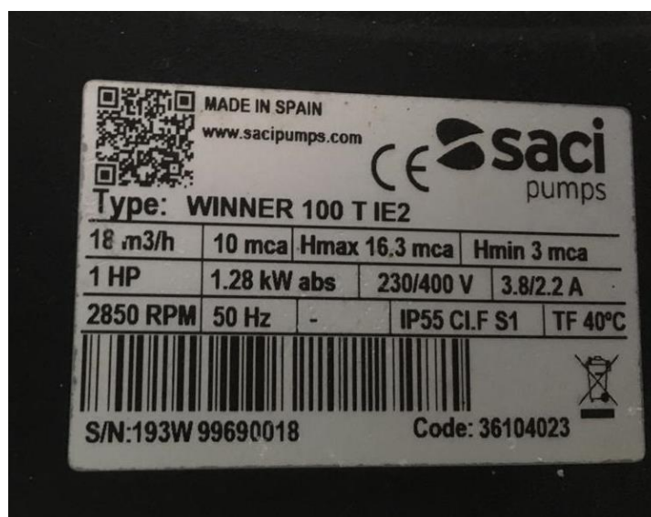
Ilustración 41. Placa características bomba, piscina chapoteo
