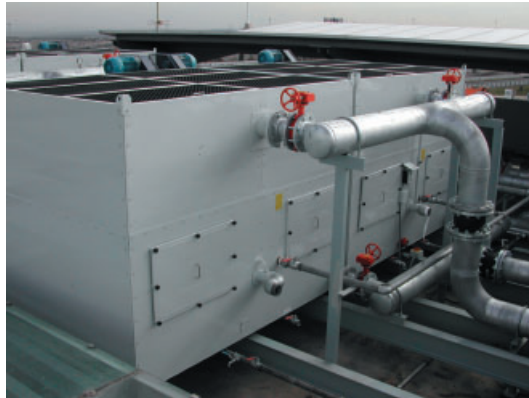
Conexión de tuberías en una torre de refrigeración APAREL modelo TC-430 RS.
