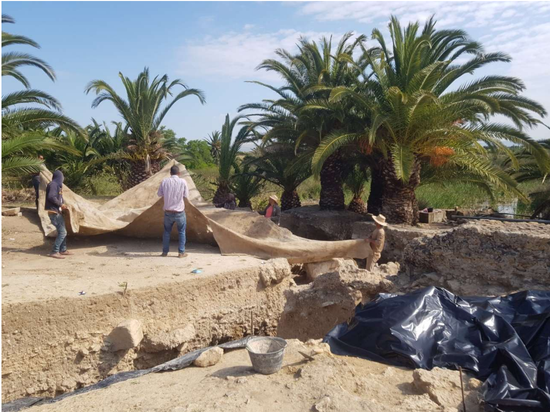
Fig. 53. Tareas de cubrición con geotextil y plástico de las estructuras del corte 18 y del corte 15.
