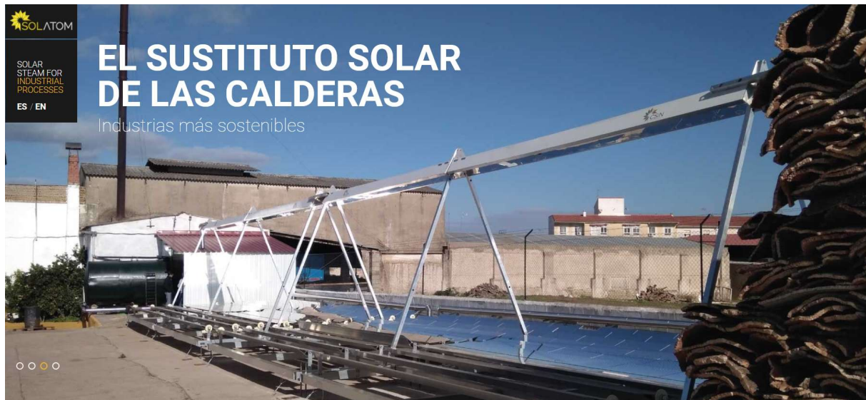
Figura 39: Ejemplo de una instalación realizada por SOLATOM mediante captadores Fresnel modulares
