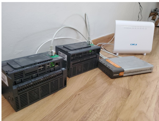
(a) Imagen de los dos PLC, switch y router.
