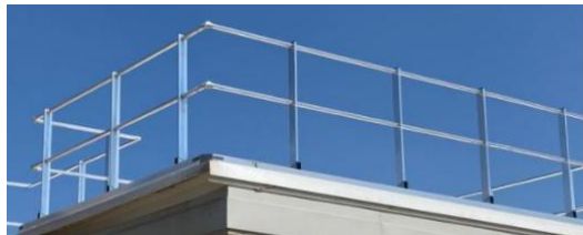
Barandilla de protección
