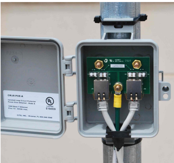
Figura 19. Protector contra sobretensiones atmosféricas.
