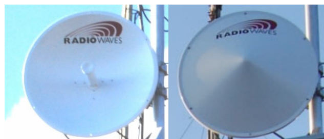
Figura 16. Izquierda: Antena parabólica sin protección Derecha: Antena parabólica con el radomo protector instalado.
