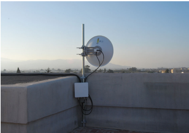
Figura 17. Ubicación equipo y antena en la cubierta de la Universidad de Almería
