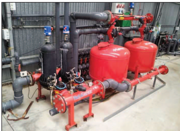
Figura 29. Filtros de arena.
