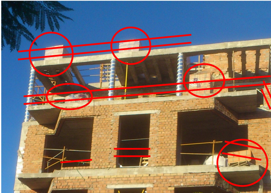
Ilustración 8: "varios riesgos de caída de material"
