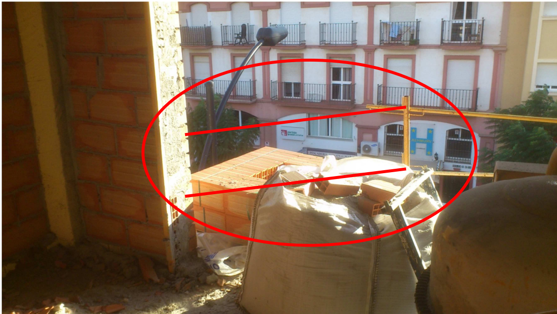
Ilustración 15: "desorden, riesgo de caída de material y de trabajadores"
