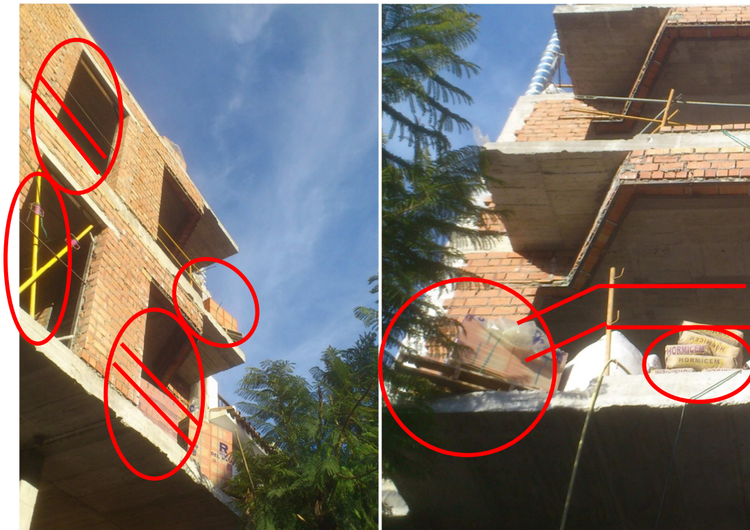
Ilustración 5: "caída sin barandilla ni red y riesgo de caída de material"
