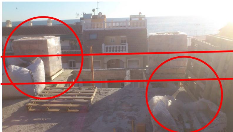
Ilustración 7: "riesgo de caída de material o trabajadores"
