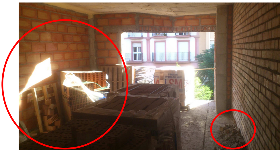
Ilustración 12: "desorden de materiales y almacenamiento de escombros"
