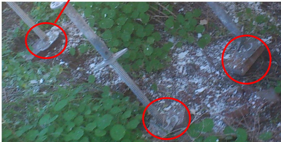
Ilustración 26: "apoyos en zonas inestables"
