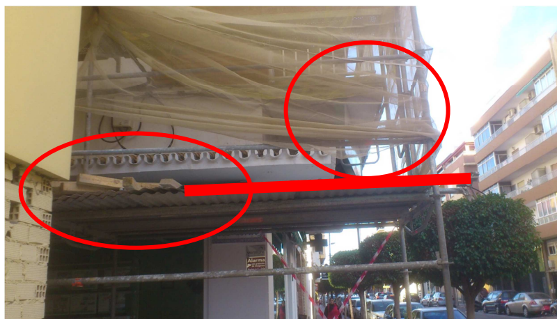
Ilustración 19: “zona transitable por trabajadores sin rodapié, red mal instalada y mal acopio de material”
