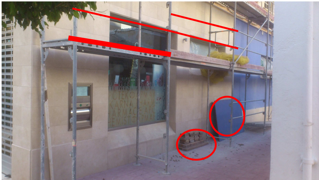
Ilustración 20: "andamio sin rodapié ni barandillas"
