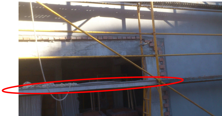
Ilustración 16: "andamio sin rodapié"
