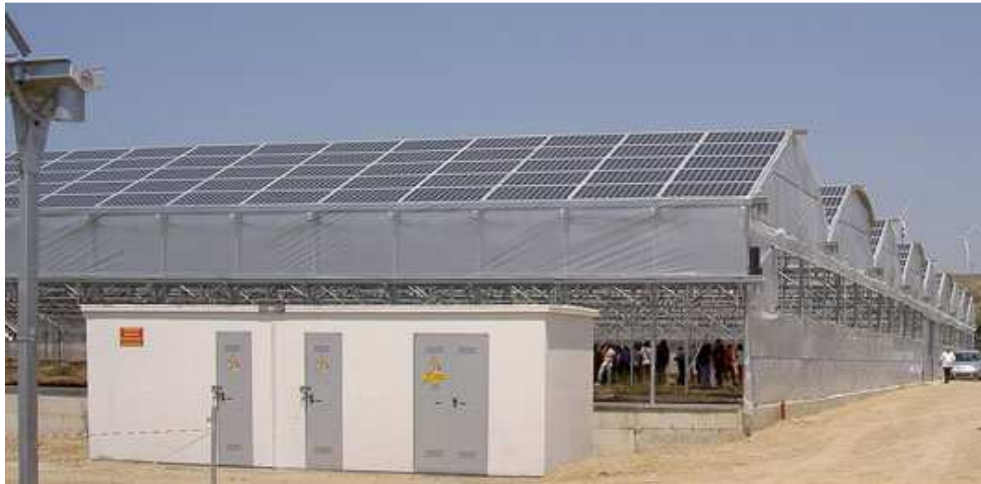
Figura 2.3. Invernadero multicapilla fotovoltaico.
