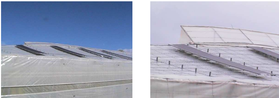
Figura 3.8. Fotografías que muestran el sistema de instalación de los paneles fotovoltaicos sobre la cubierta.
