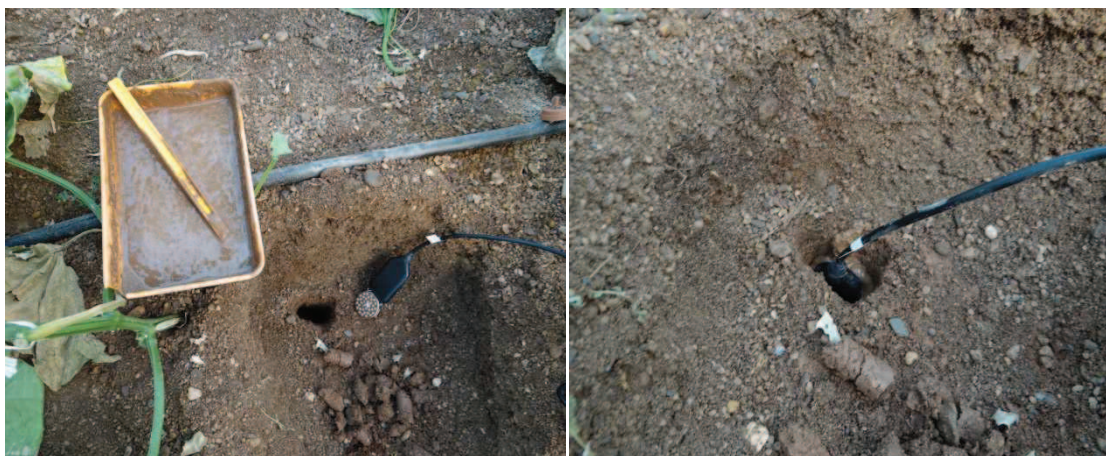
Fotografía 3.1 Detalle de la instalación del MPS2
