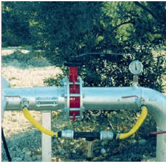
Foto 31. Manómetro para verificar presión en funcionamiento de Venturi.
