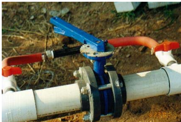
Foto 1. Venturi instalado en sistema de fertirrigación. Centro de Capacitación en Agricultura Tropical.(CCAT) La Huerta, Jalisco. México. Universidad de Guadalajara
