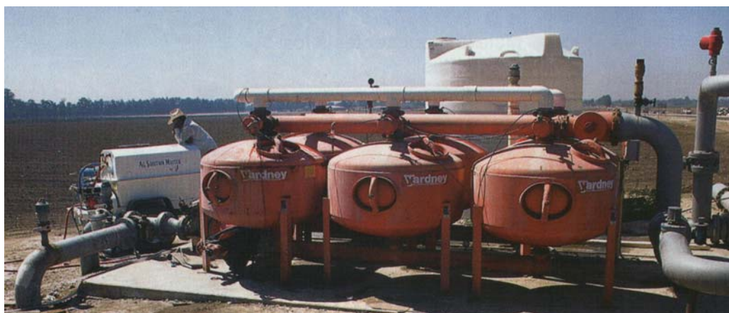
Foto 13. Batería de filtros de arena.
