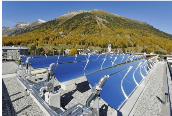
Figura 1.3 - Campo de captadores solare cilindro parabólicos de baja apertura en una aplicación industrial en Suecia. Fuente: ( www.nep-solar.com ).
