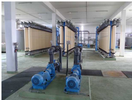
Foto 2. Terciario, microfiltración de la EDAR El Ejido
