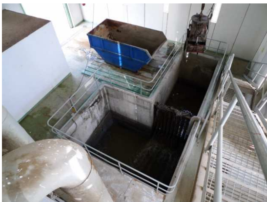
Foto 3. Zona de desbaste de la EDAR El Ejido
