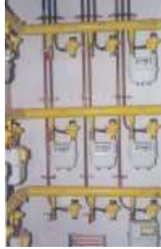
Figura 5. Armario de contadores
