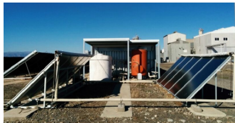
Figura 1. Instalación piloto de la PSA.
