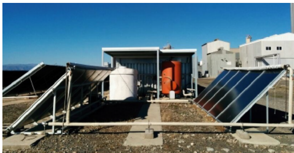
Figura 1: Instalación piloto de la PSA.
