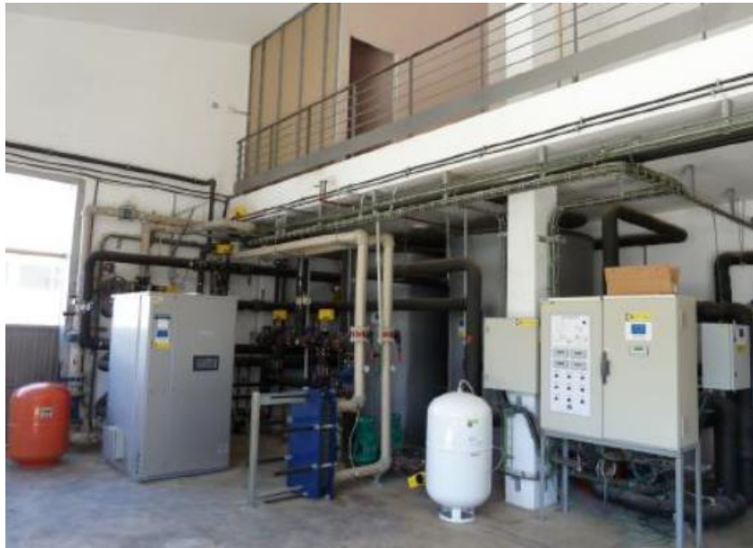
Figura 3.5 Instalación de frío solar
