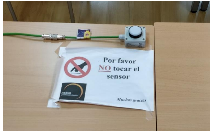
Figura 3.19 Luxómetro de la sala de juntas
