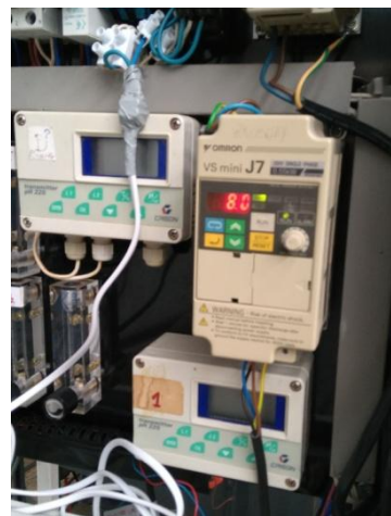
Figura 11. Variador de frecuencia
