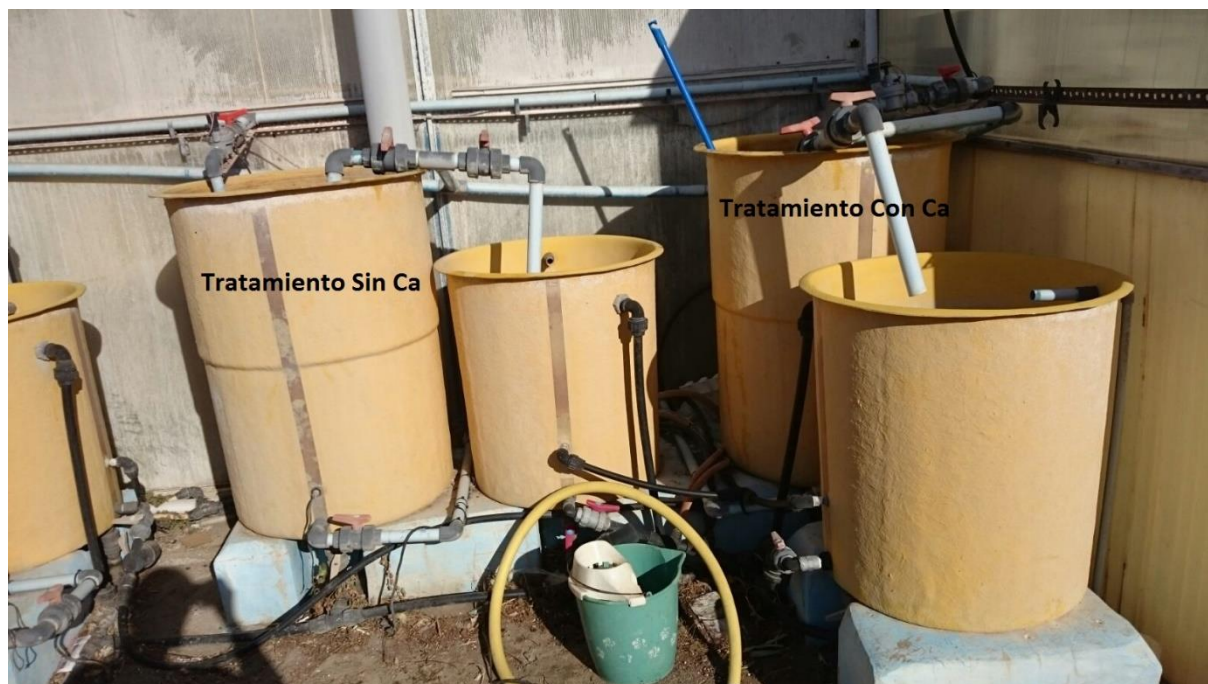
Fotografía 7: Tanques de fertirriego.
