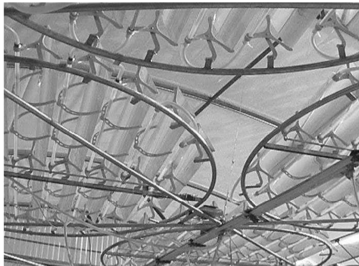
Figura 21. Sistema versátil de lentes y la concentración de la absorción de la luz del sol, montado en el marco del techo de un invernadero
