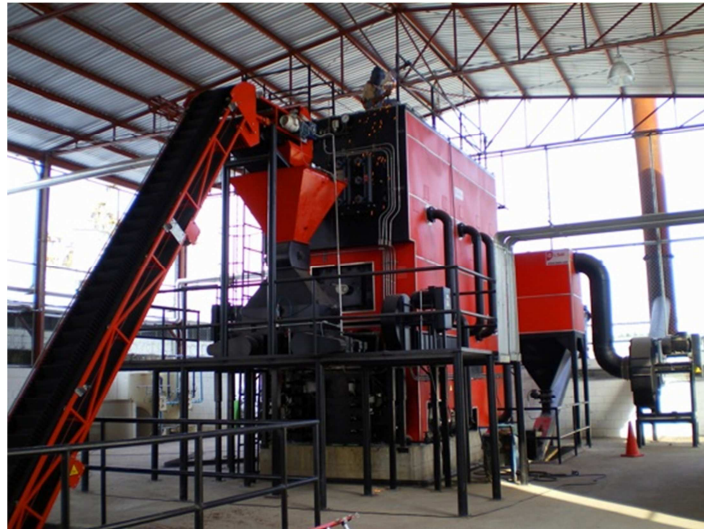
Figura 10. Caldera de biomasa.
