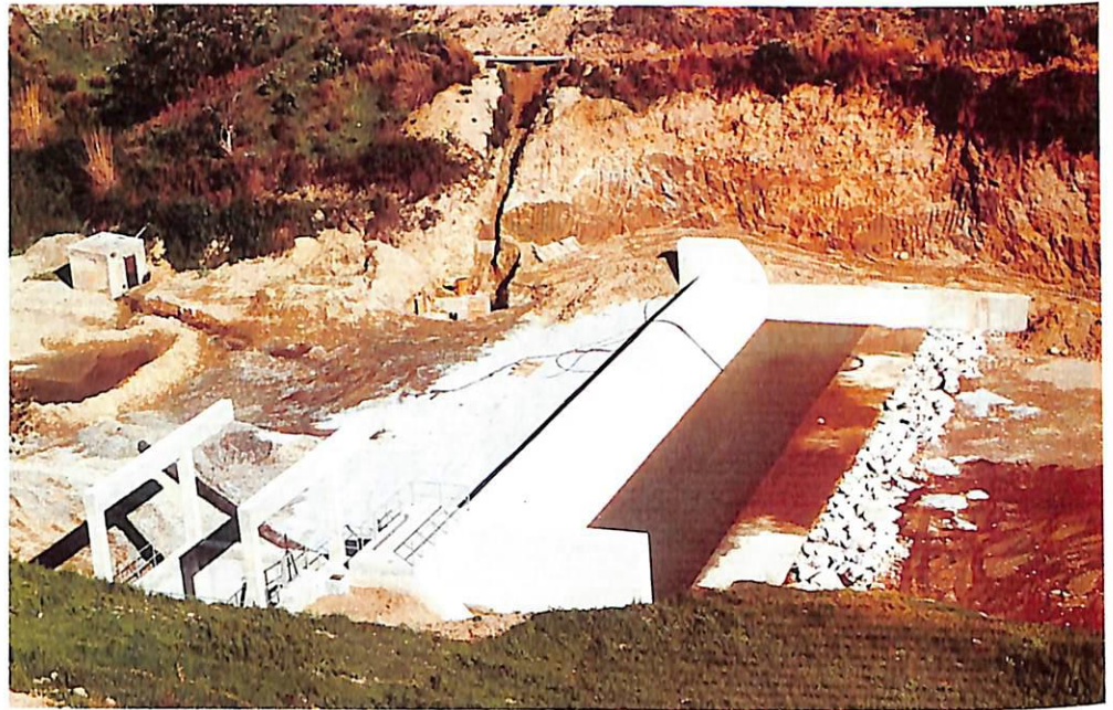
Captación agua Río de la Miel.
