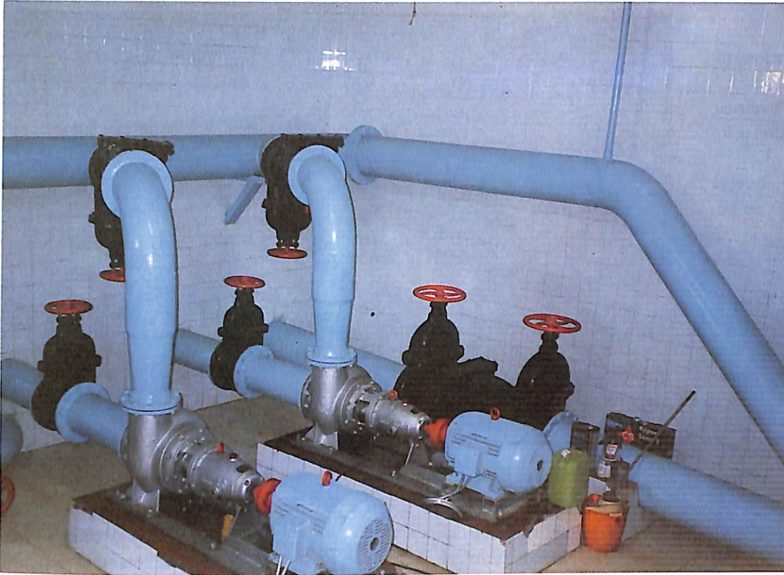
Estación de bombeo emisario submarino.
