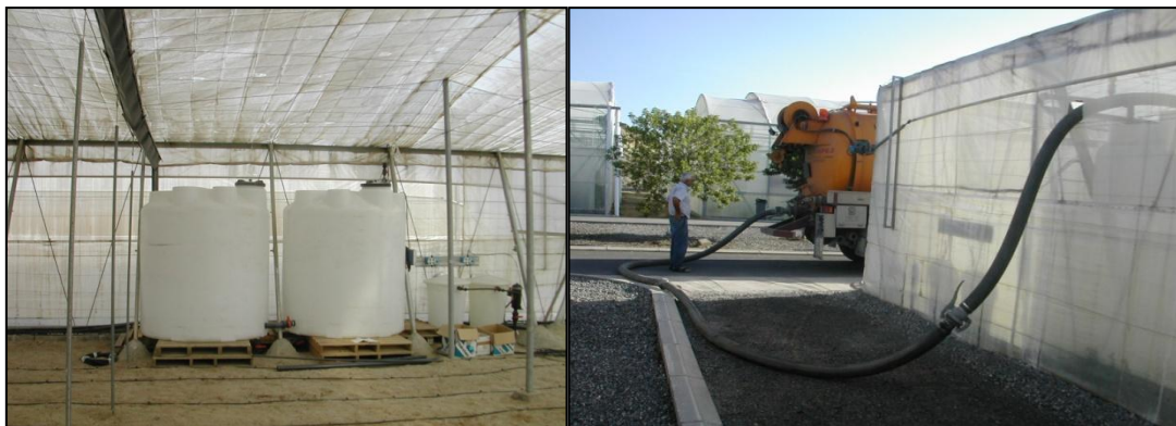
Foto 1. Detalle de los depósitos y de su llenado por la parte posterior
