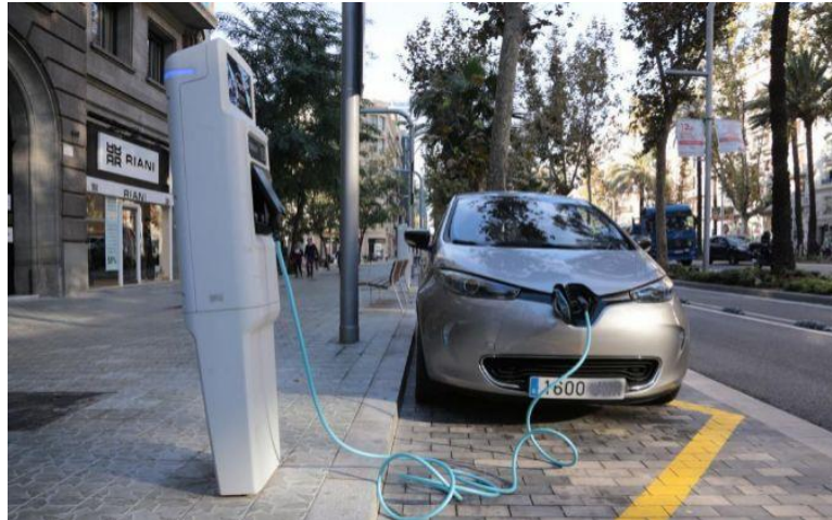
Figura 2.20: Punto de recarga en la vía pública. Fuente ElectroMovilidad. 20
