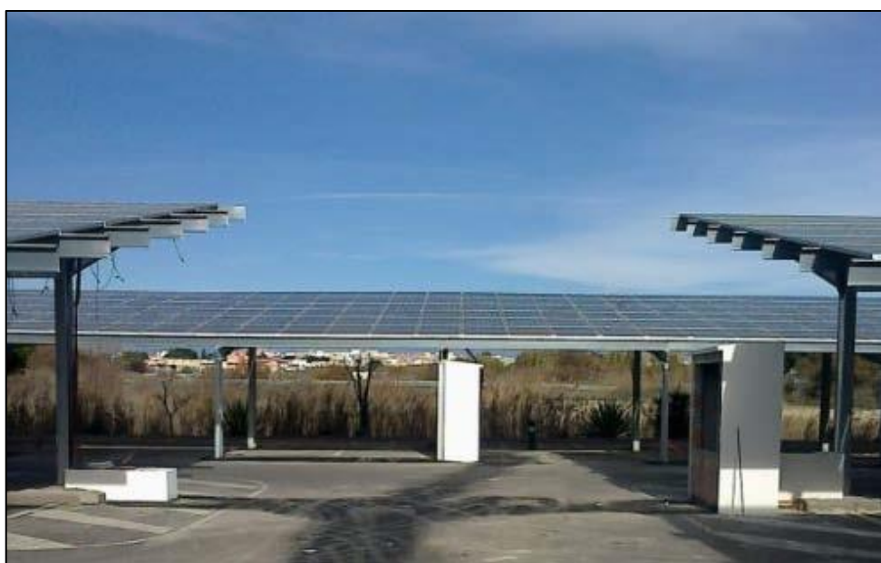
Figura 3.10. Vista del parking fotovoltaico de la UAL
