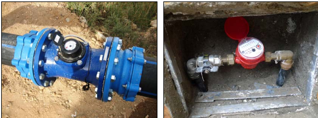
A la izquierda contador tipo Woltman en sistema de aducción. A la derecha contador de suministro domiciliario. Fotos del autor.
