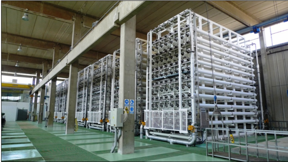
Bastidores de ósmosis inversa de la desaladora de Almería. Foto del autor.
