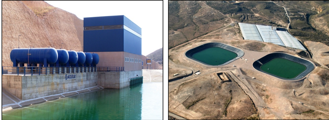
A la izquierda estación de impulsión desde la desaladora de Carboneras hasta las balsas de Venta del Pobre. A la derecha Balsas de Venta del Pobre. Fotos del autor y cortesía de Dragados S.A. (derecha).
