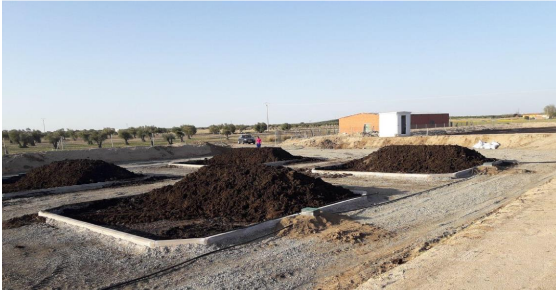
Figura 8. Pilas de compostaje ubicadas en el municipio de Mora (Toledo). Proyecto LIFE16 ENV/ES/000331.
