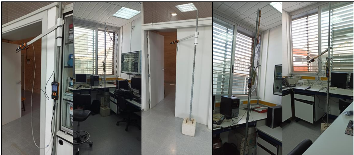
Figura 20. Instrumentos de medida: Testo 445 y Testo 440 con diferentes sondas usados en las mediciones de los cuadrantes de la puerta y las ventanas.
