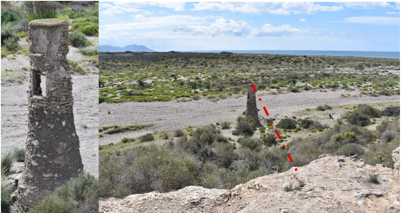
Figura 7. El Pocico. A la derecha, detalle de la erosión (imágenes: Proyecto AQVA).
