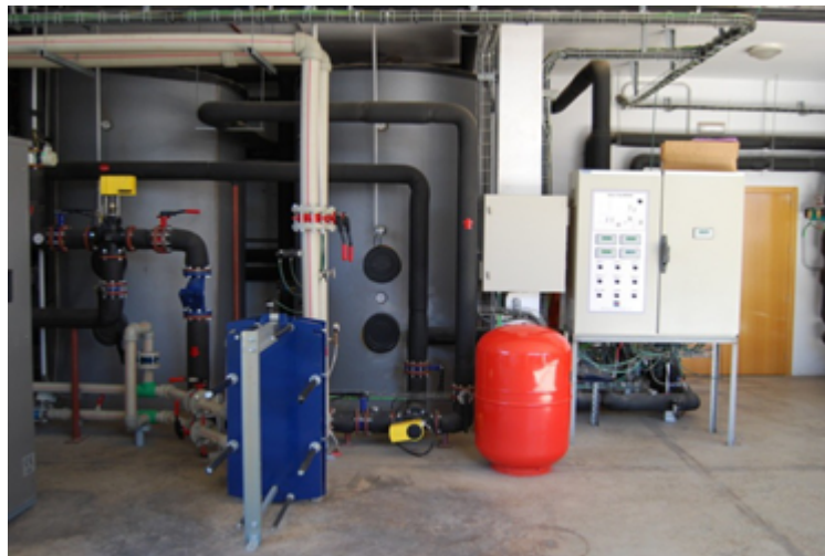
Figura 8. Dos tanques de acumulación de agua caliente de 5000 litros cada uno.
