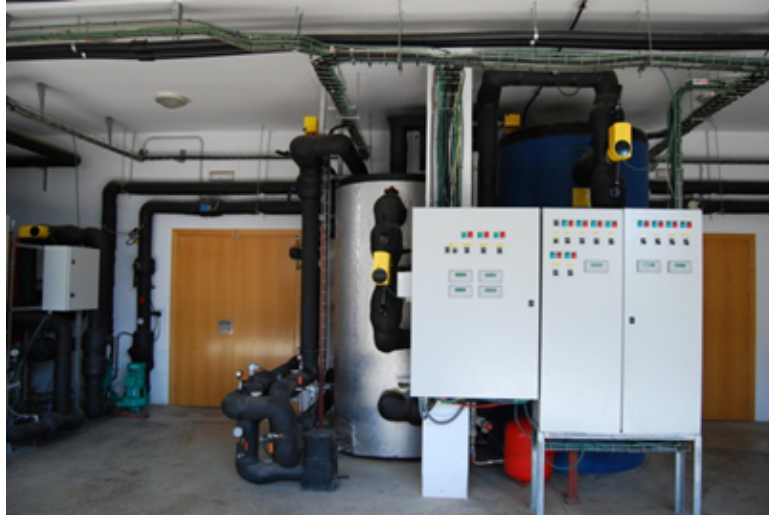
Figura 14. Sistema de acumulación de agua fría.
