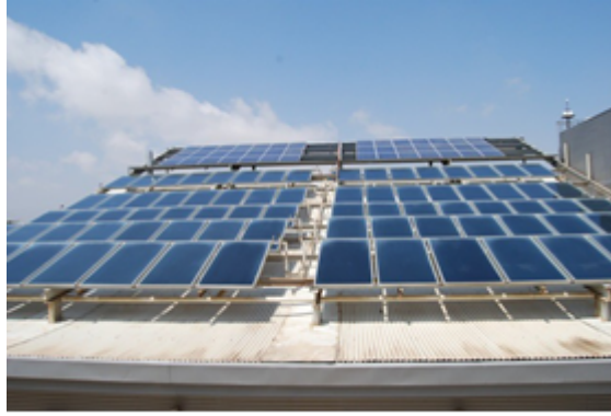
Figura 7. El campo solar constituido por 80 captadores Solaris CP1 y 42 módulos fotovoltaicos. Sistema de acumulación.
