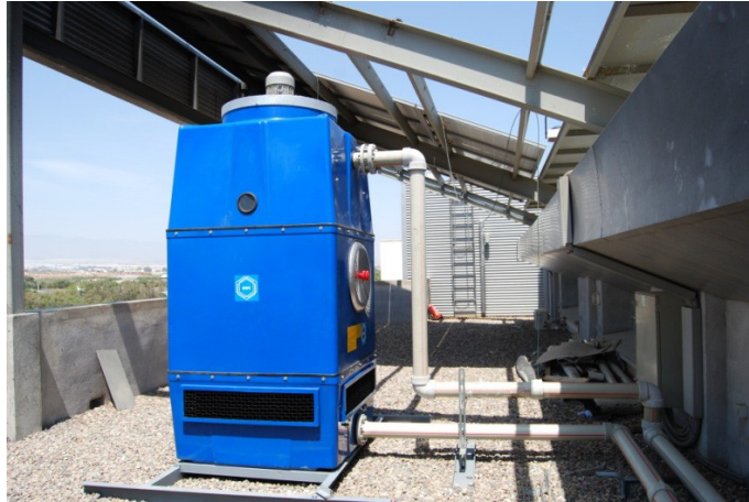
Figura 11. Torre de refrigeración Sulzer EWK 100.
