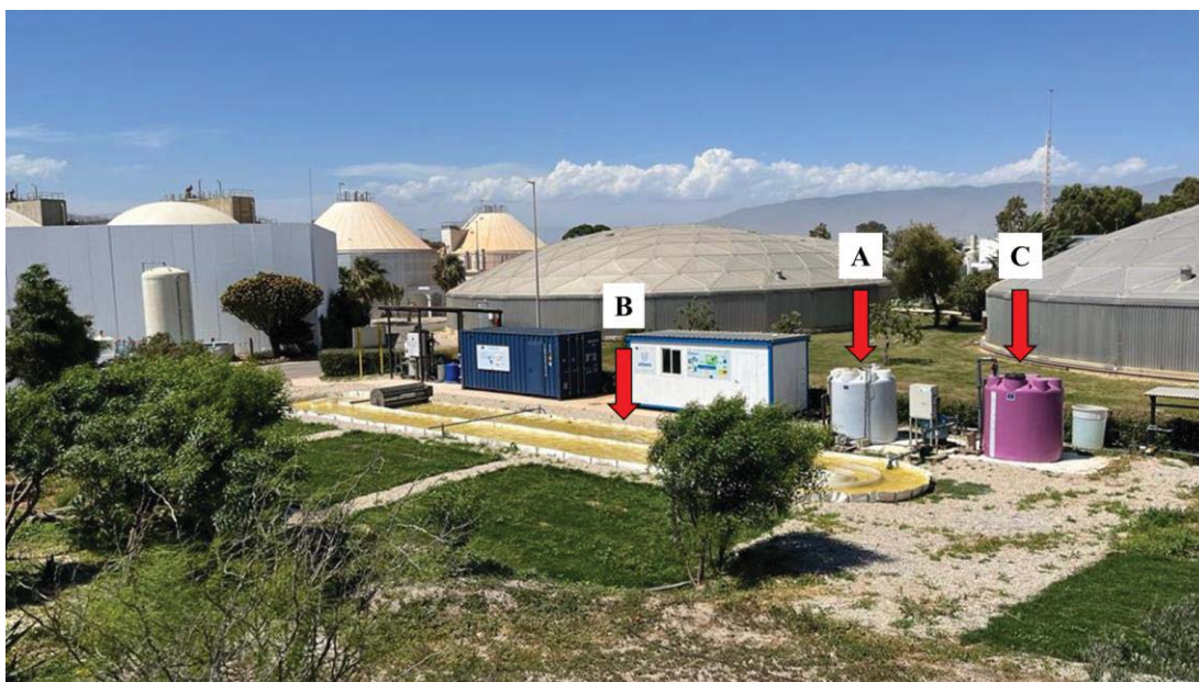
Figura 18. Planta de tratamiento terciario por foto-Fenton solar. Punto A (tanque de acondicionamiento, agua bruta), B (reactor) y C (agua tratada, salida filtro).
