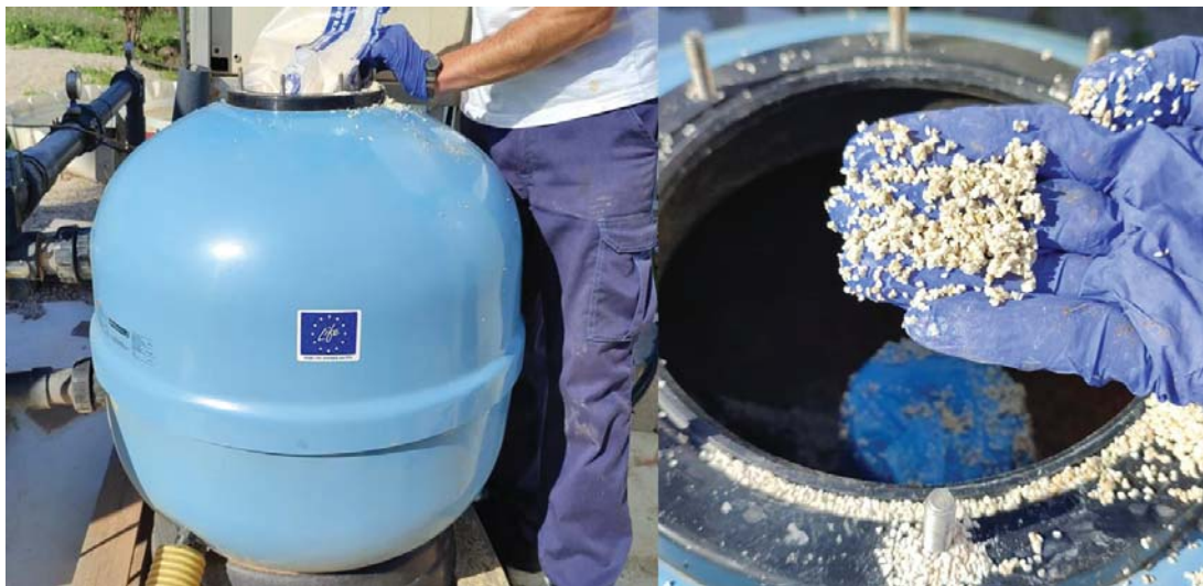
Figura 16. Filtro de carbonato cálcico utilizado para la neutralización del agua regenerada perteneciente al Proyecto Life Ulises.
