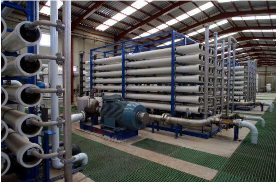
Figura 25. Módulos de ultrafiltración por ósmosis inversa en la desaladora del Bajo Andarax.
