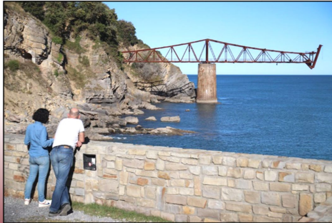
Ilustración 8. Cargadero de Dicedo (Cantabria). Fuente: El Diario Montañés [En línea]. Recuperado el 8 de junio de 2022, de https://www.eldiariomontanes.es/region/cantabria/oriental/rehabilitan-cargadero-mineral-201912-29192035-nova.html?ref=facebook&fbclid=IwAR1v9w0qj0v0m7u
