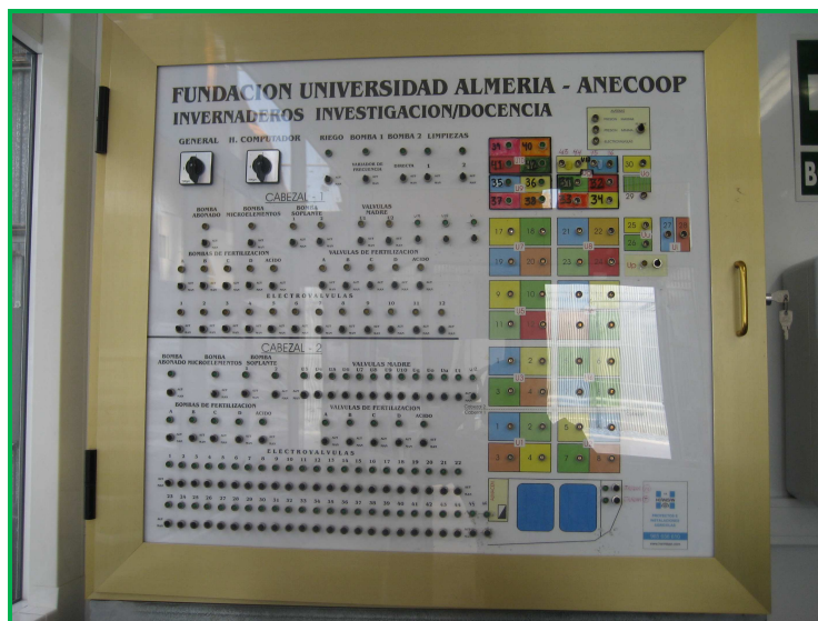
Figura 55. Detalle del panel o cuadro de control.
