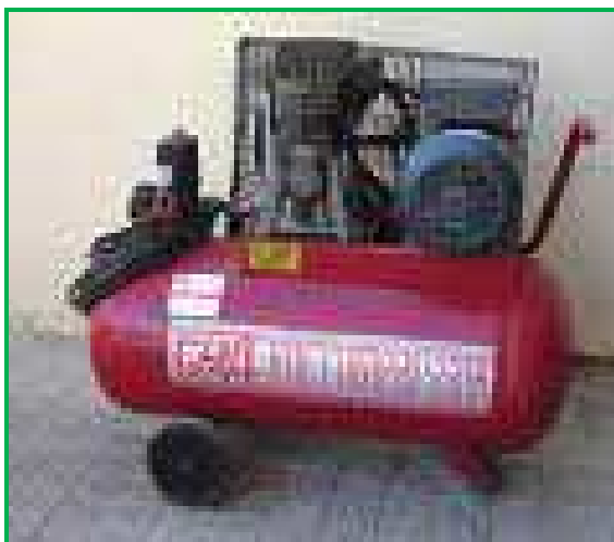
Figura 51. Detalle del compresor de aire.
