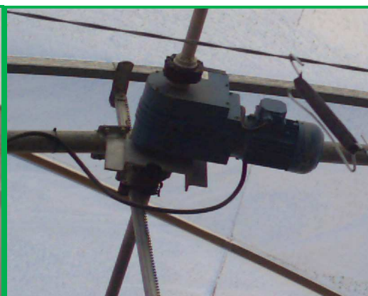
Figura 60. Detalle del motoreductor que acciona a apertura y cierre de la ventana.
