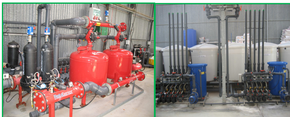
Figura 47. Detalle del filtro de arena.
