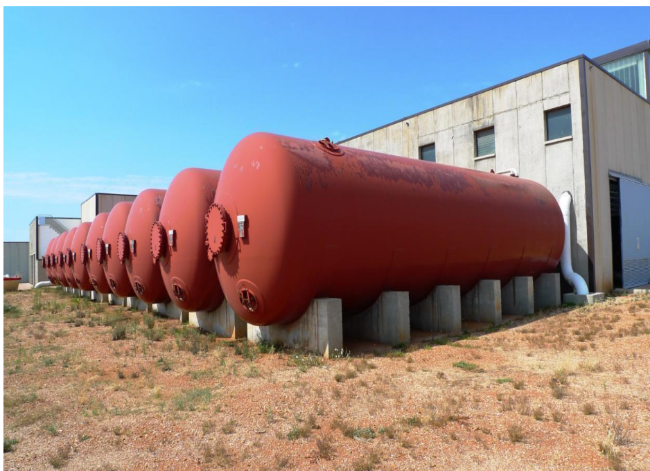
Foto 1. Filtros de arena.
