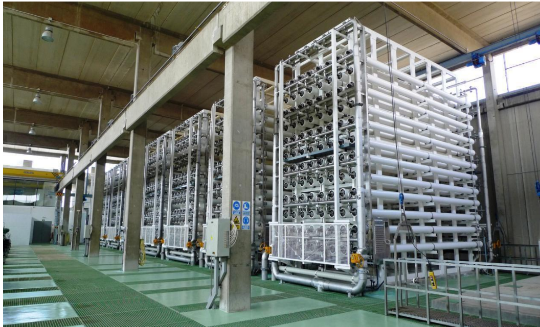
Foto 3. Bastidores de ósmosis inversa.
