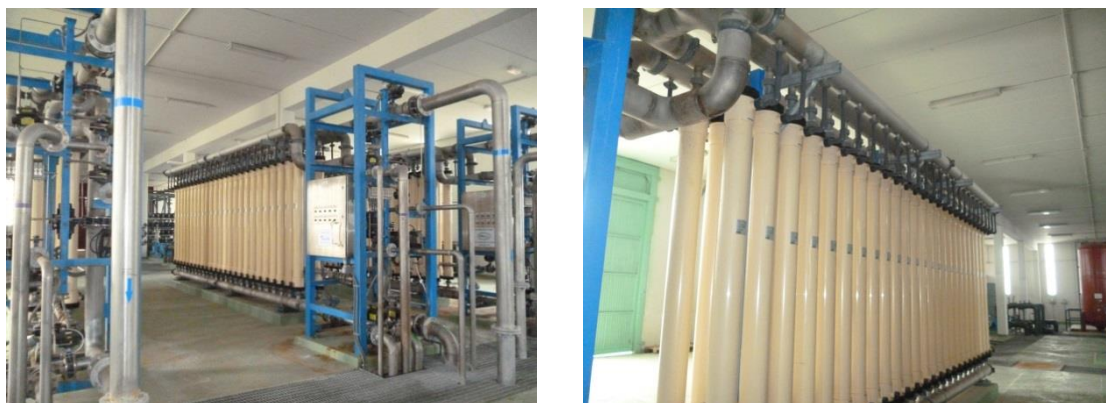
Foto 5 Vista lateral de la Microfiltración
