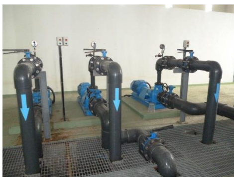
Foto 11 Bombas de riego
