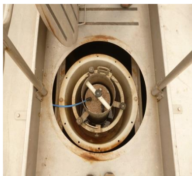
Foto 3 Vista superior de tubo donde va introducida la bomba mamut. Fuente: Propia.
