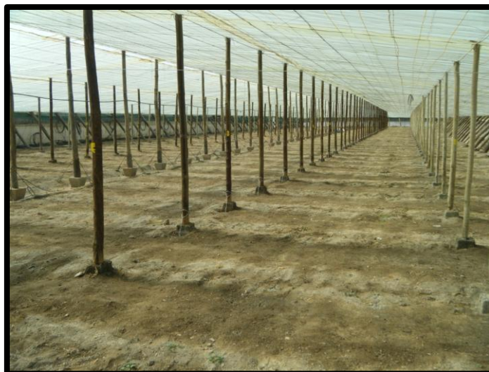
Figura 10: Detalle de la estructura y estado del suelo del invernadero 3.1.
