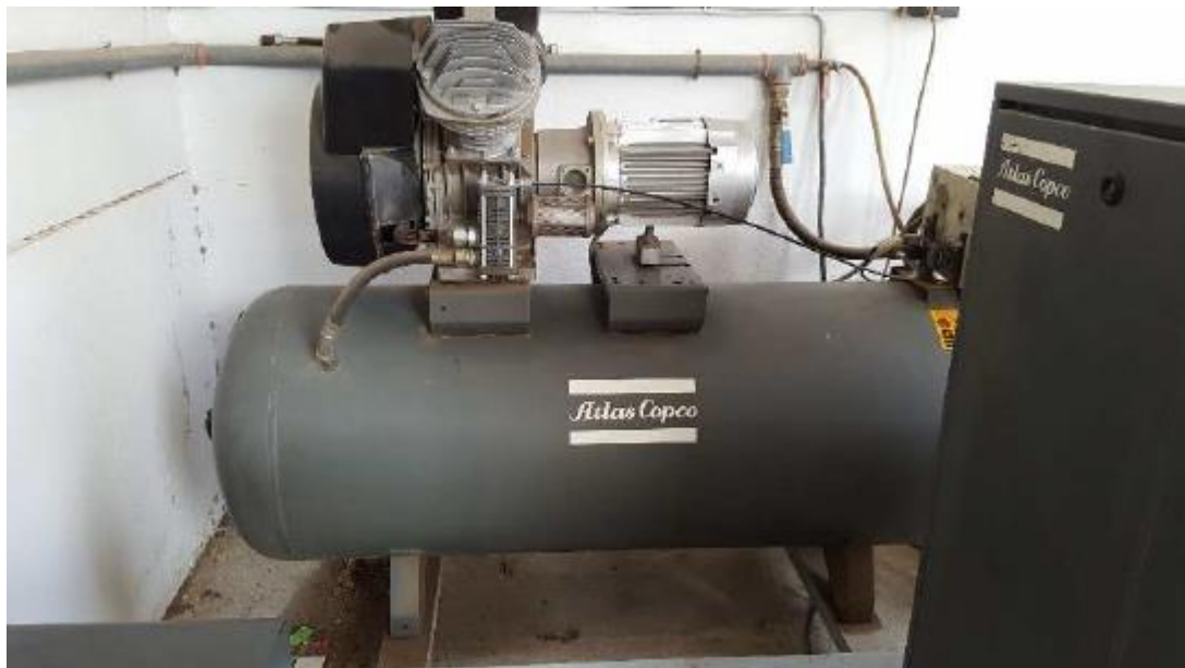
Figura 24. Calderín del compresor
