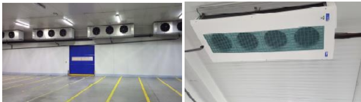
Figura 19. Unidades interiores de las cámaras frigoríficas
