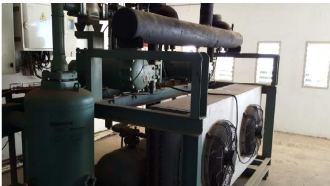
Figura 18. Compresores de cámara frigorífica
