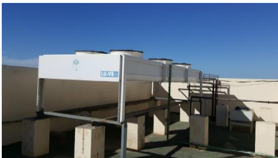
Figura 20. Condensadores de las cámaras frigoríficas
