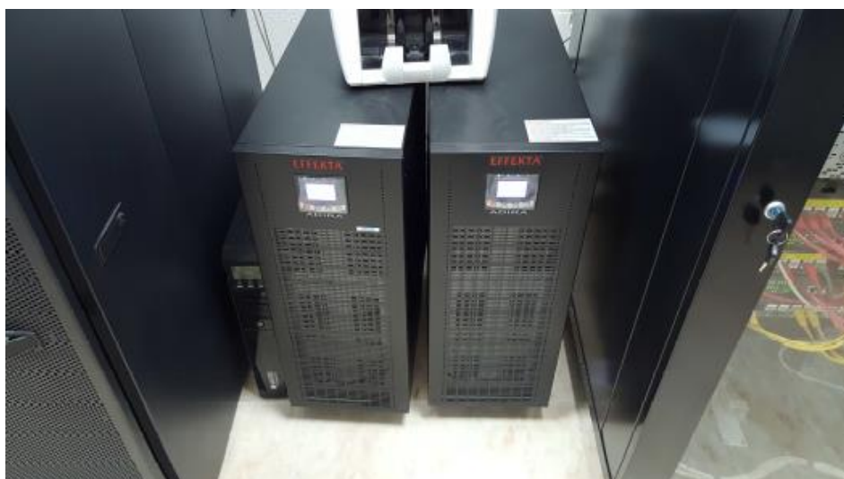
Figura 11. Sistemas de alimentación ininterrumpida (SAIs)
