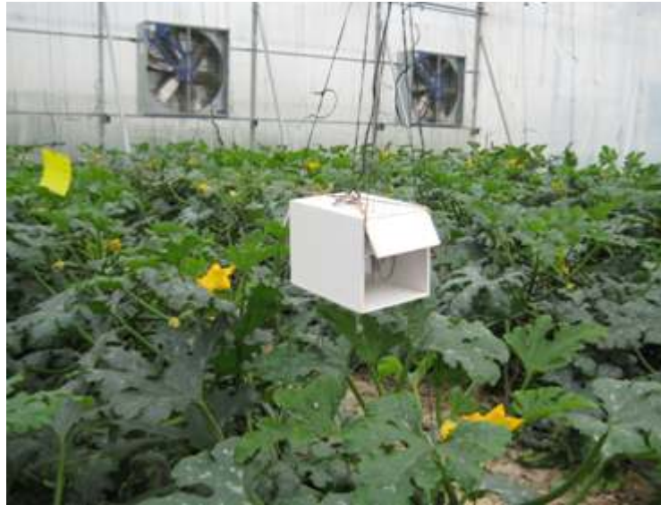
Figura 10. Detalle de un sensor de temperatura y humedad relativa en el interior de un invernadero (Hobo). EP
