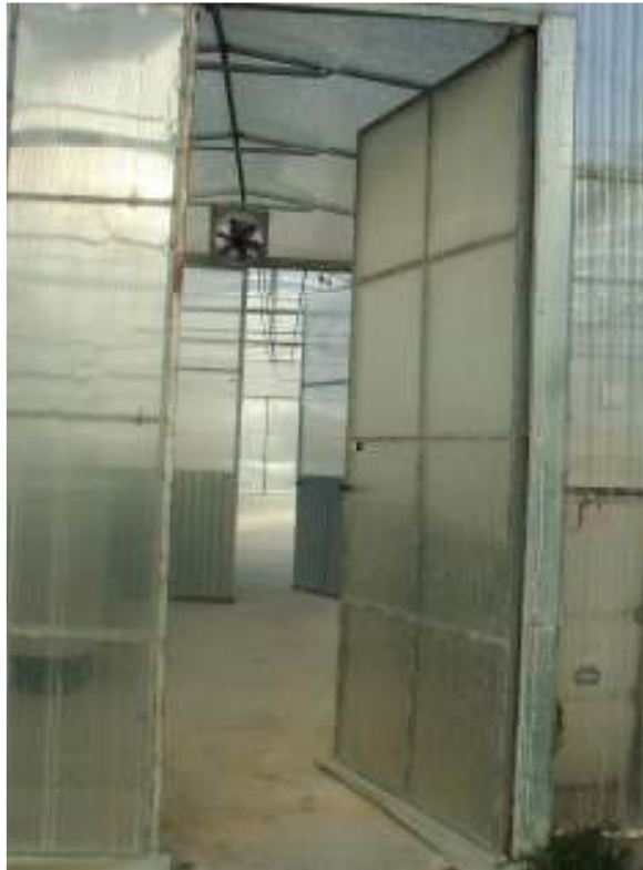
Figura 13. Detalle de la puerta de doble cierre instalada en los invernaderos. EP
