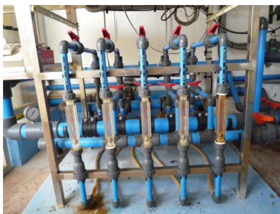
Figura 38. Sistema de inyección.
