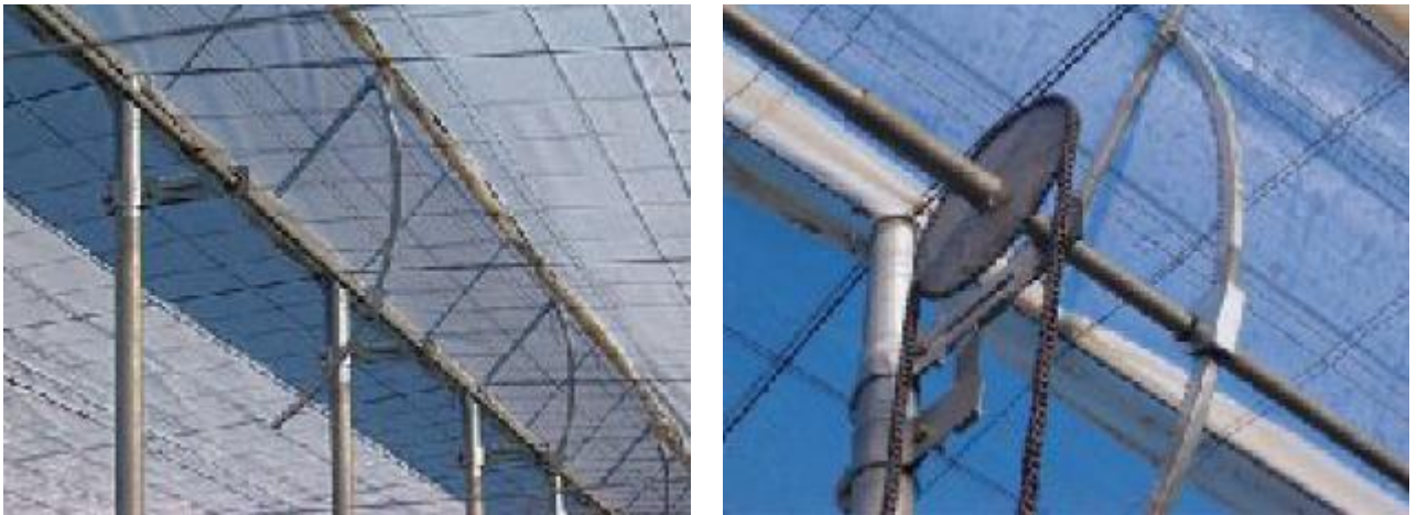
Figuras 3 y 4: Accionamiento ventanas (Fuente: Villegas Moreno S.L.)
