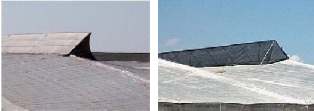
Figuras 1 y 2: Tipo de ventilación cenital (Fuente: Villegas Moreno S.L.)
