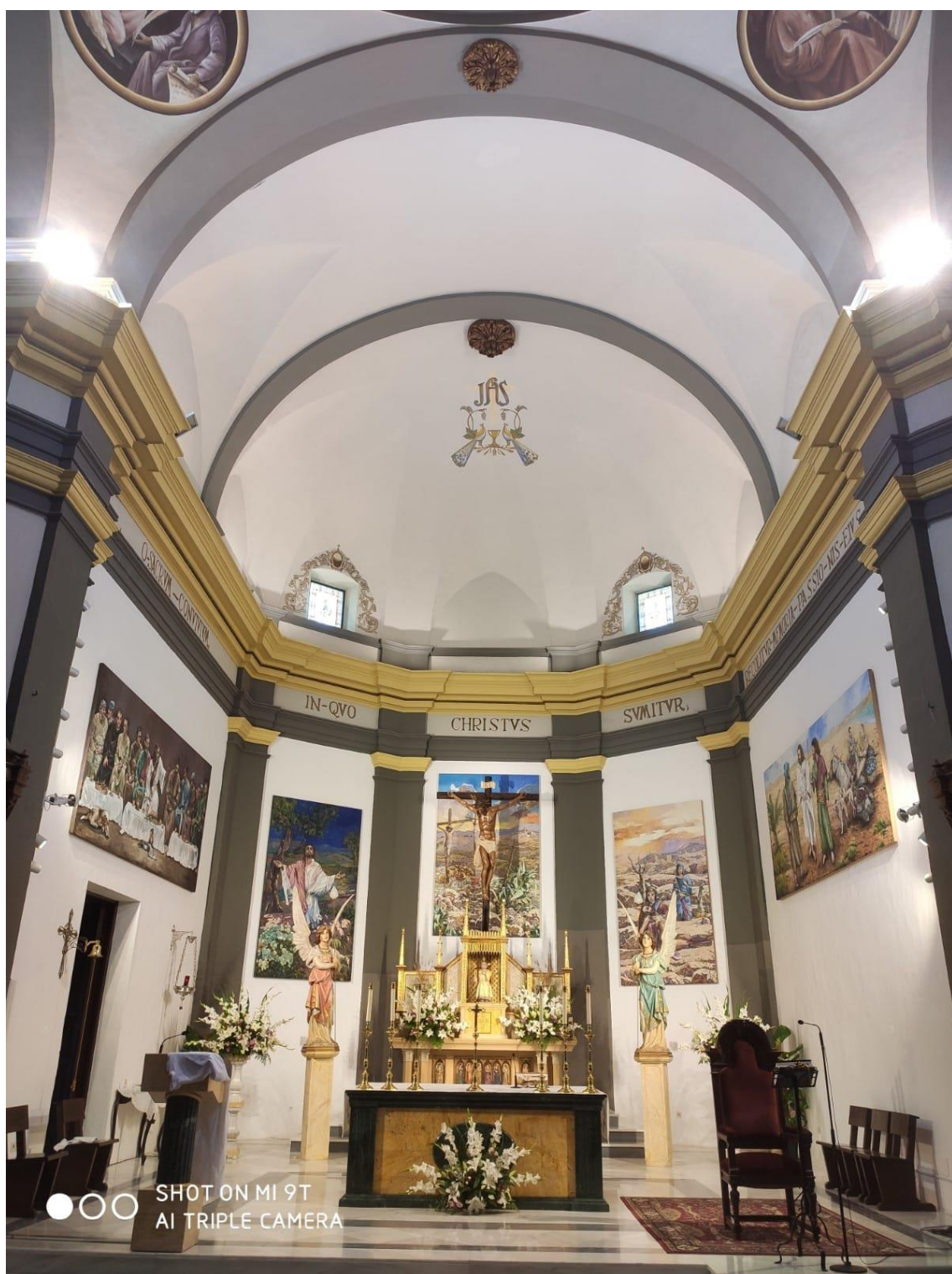
Lámina VIII. Vista del presbiterio, ligeramente elevado sobre el resto del templo, por medio de unos escalones. Es un espacio cerrado por cinco paramentos. La foto es posterior a la restauración de este espacio, en 2012. Las tres pinturas del ábside han sido sustituidas por otras, aparecen dos cuadros, a derecha e izquierda, antes inexistentes. Ya aparece cegada la puerta de la derecha.
