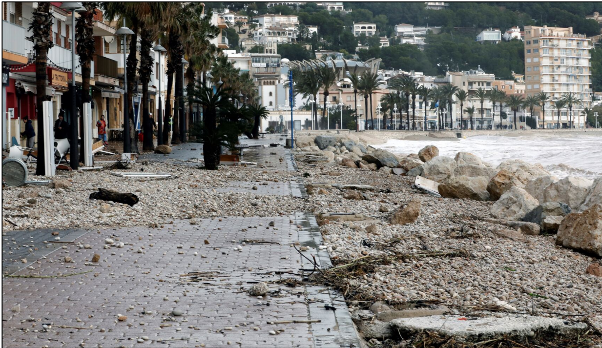
Desperfectos causados por las intensas lluvias causados por el temporal Gloria en Jávea. Fuente: https://www.elespanol.com/ciencia/meteorologia/20200121/nueva-alerta-meteorologica-maximo-provincias-borrasca-gloria/461454027_0.html (consultada el 21-1-2020).
